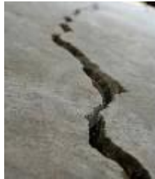
Crack: 갈라진 틈, 깨진 틈, 금
